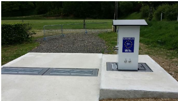
Abbildung 4 Entsorgungsstation Eurolais, wohnmobilland-schweiz.ch
