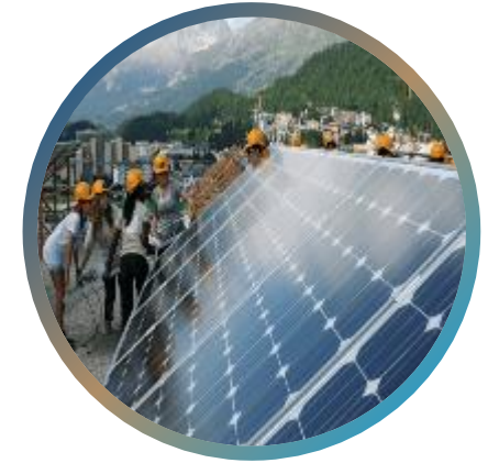
Schweizer Jugendherbergen: Installation PV-Anlagen
